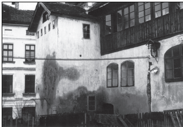
Zanedbaný stav domu v Prachaticích
